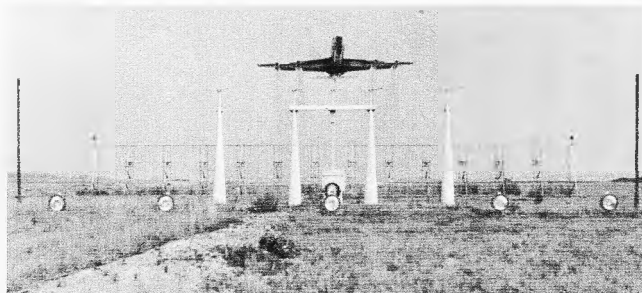
Bild 13. Der Landekursender LK 2 der ILS-Anlage am Ende der Startbahn des Rhein/Main-Flughafens bei Frankfurt/Main. Foto: SEL.
